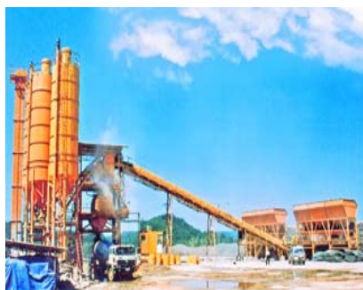
Trạm trộn Bê tông đầm lăn IMI Công suất : 120m 3 /h
